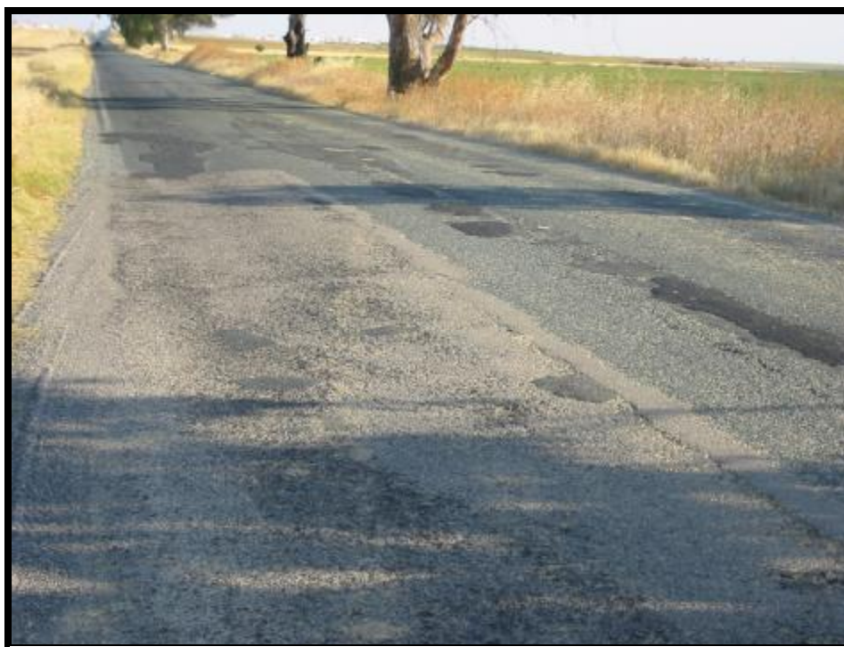
Foto 45.-Problemas de pavimentación en la carretera de Guadajoz (SE-122).
