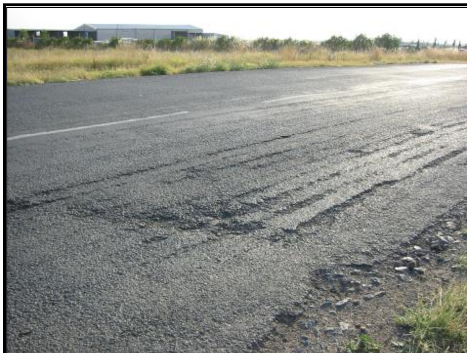
Foto 44.-Grandes surcos en la carretera de Brenes (A-460).
