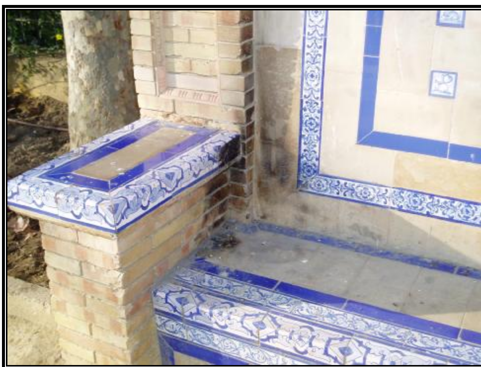
Foto 58.-Quemaduras en los bancos de la Alameda.
