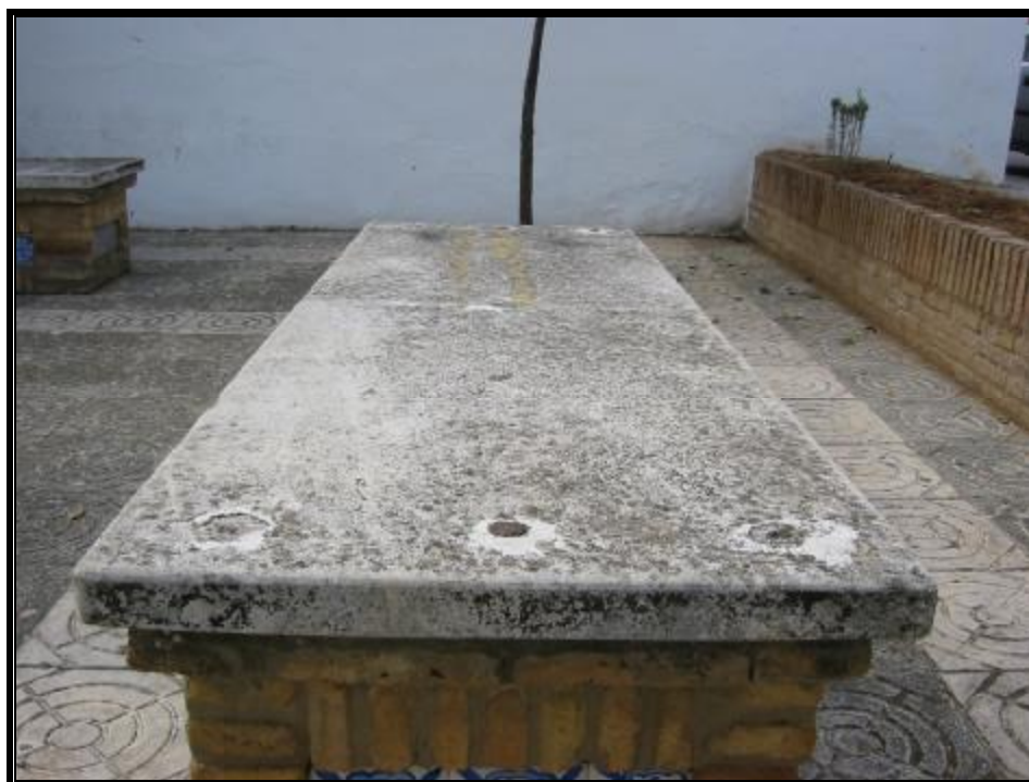
Foto 57.-Destrozos de bancos en la Plaza de la Constitución.
